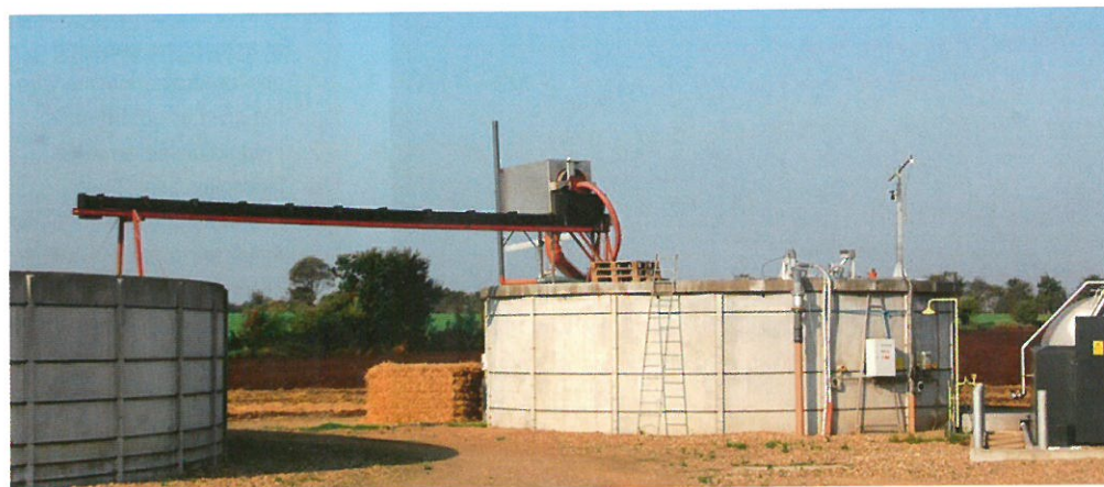
Procestank med JH Smellfighter placeret ovenpå og en snegl, der fører fiberdelen til gylletanken.
